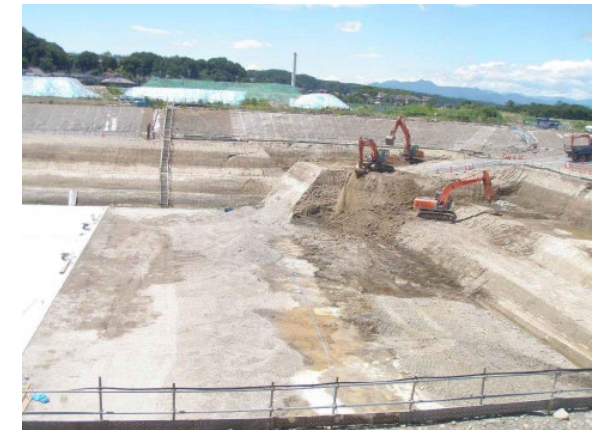
④ 開削工事のドライワーク (東京都下水道局発注、八王子水再生センター西系水処理施設建設工事、平成26年～29年、東京都)
