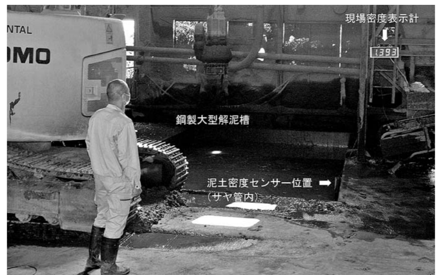
写真1: 現場デジタル表示計/佛富士機京浜島プラント
