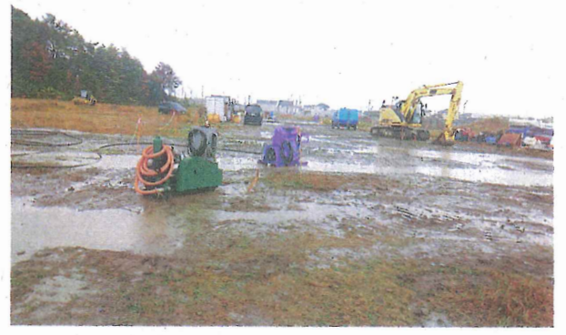
沈下状況全景(SWP No.3~No.4間、南東方向)
