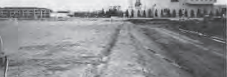
地盤改良とラブリック、スーパーウェルポイントの設置と効果
