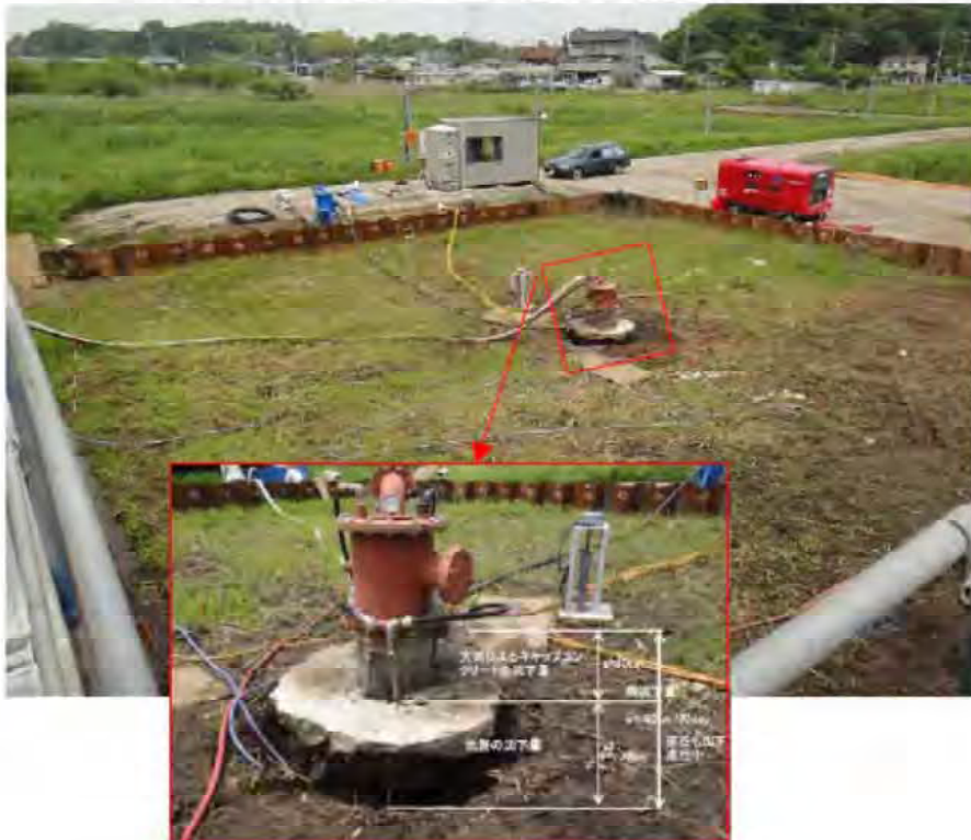
SKK設置状況
